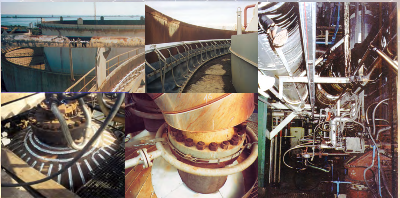
Monitoreo de temperaturas Superficies externas reactores
